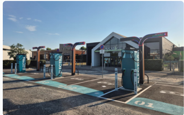
Bornes de recharges électriques sur l'actif de Mérignac.
